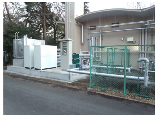
水熱利用システム (オルガノ開発センター)
