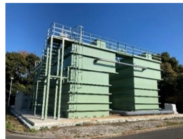
東京都砂町水再生センター グラニューール形成槽
