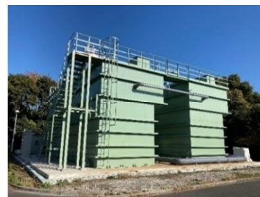
東京都砂町水再生センター グラニュール形成槽
