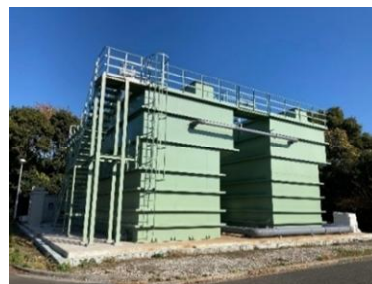
東京都砂町水再生センター グラニュール形成槽
